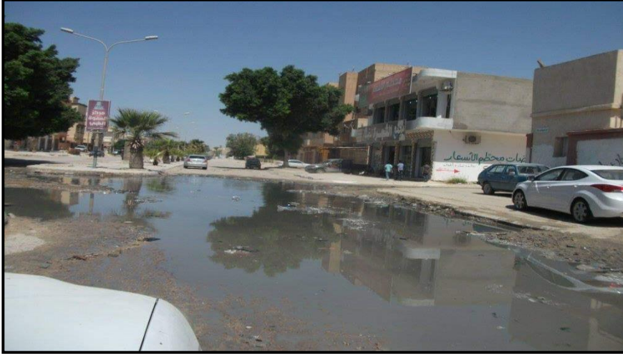
شكل (5) مشكلة طفح مياه الصرف الصحي بمدينة إجدابيا في محلة الوحدة العربية.
